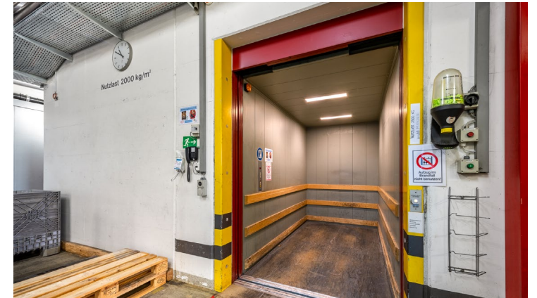
Warenlift, UG - OG
